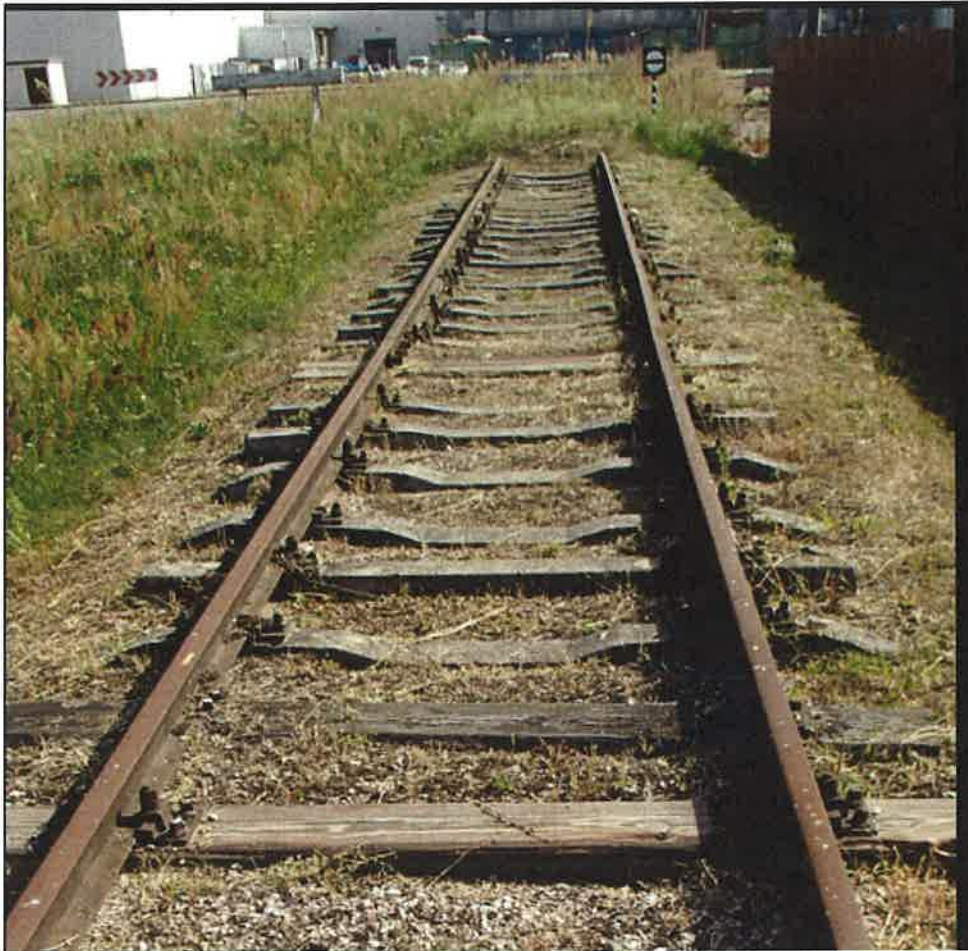
Zdjęcie nr 11. Zachwaszczenie kozła oraz brak pojedynczych przytwierdzeń.
