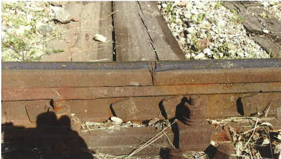
Zdjęcie nr 7. Wykruszenia główki szyny w styku.
