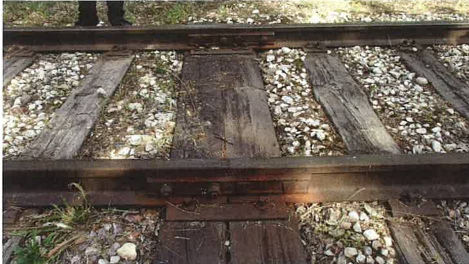
Zdjęcie nr 6. Nakrętki ze śrub łubkowych po niewłaściwej stronie.
